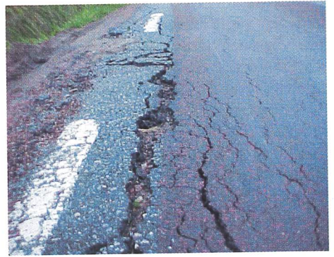
När väggroppen kollapsar av tung trafik
