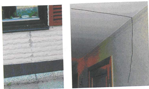
Figur 5. Typiska skador i fasad och överhäng. I bilden till höger har sprickorna fyllts i fotot för att mönstret skall bli tydligt.
